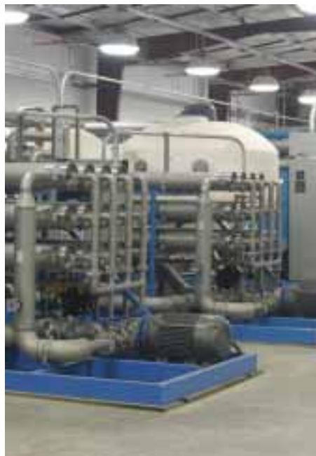
Planta de Osmosis Inversa
