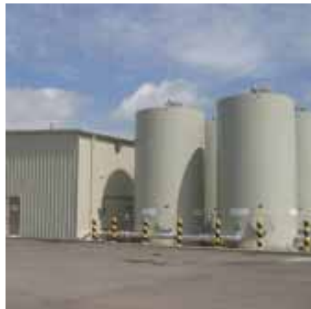
Planta de ósmosis inversa
