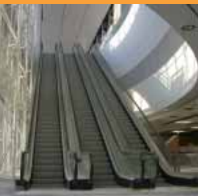
Escaleras electricas de SkyLink
